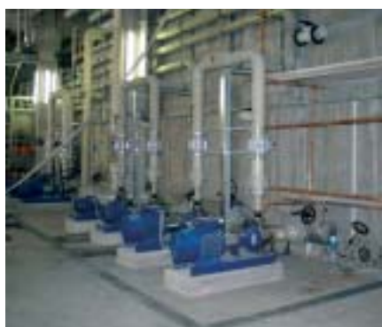
Rezervoarji in pretakišče dekarbonatizirane vode
