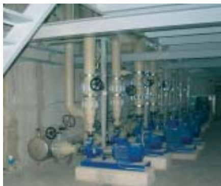
Rezervoarji in črpališče filtrirane vode
