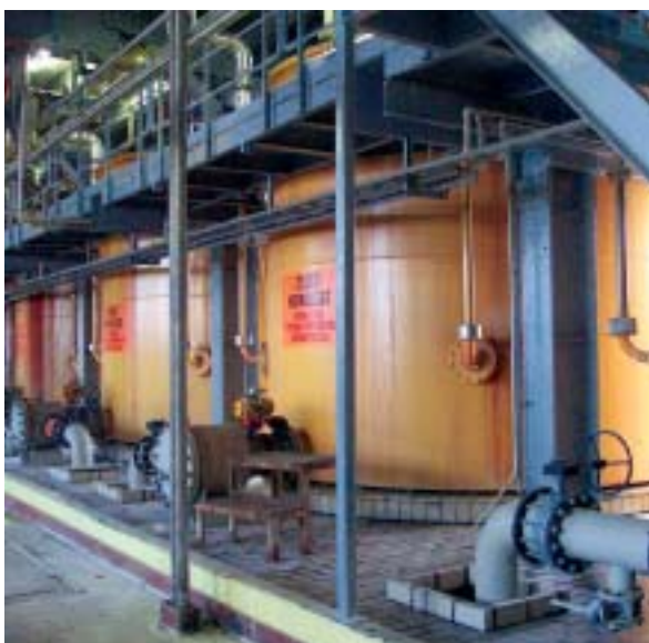
Pogled na linijo petih novih hidrolizerjev
