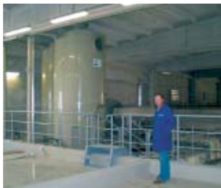
Odplinjevalniki CO_2 po procesu dekarbonatizacije
